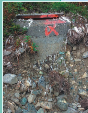
Débordement de déchets d'un collecteur d'eaux usées de Montgenèvre.
