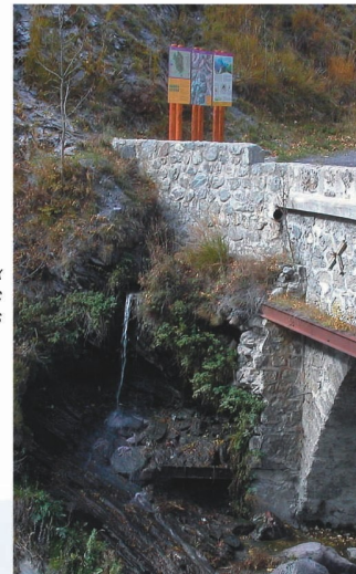
Rejet direct d'eaux usées au pied du parc National des Ecrins
